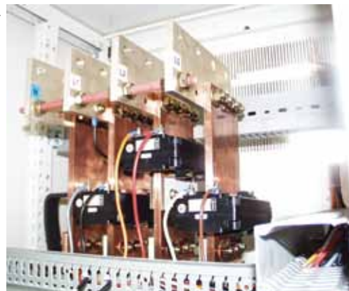
Распорки между шинами
