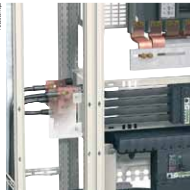
Подключение в кабельном отсеке
