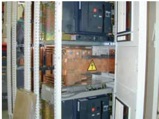
Система ввода резерва, размещённая в одной ячейке
